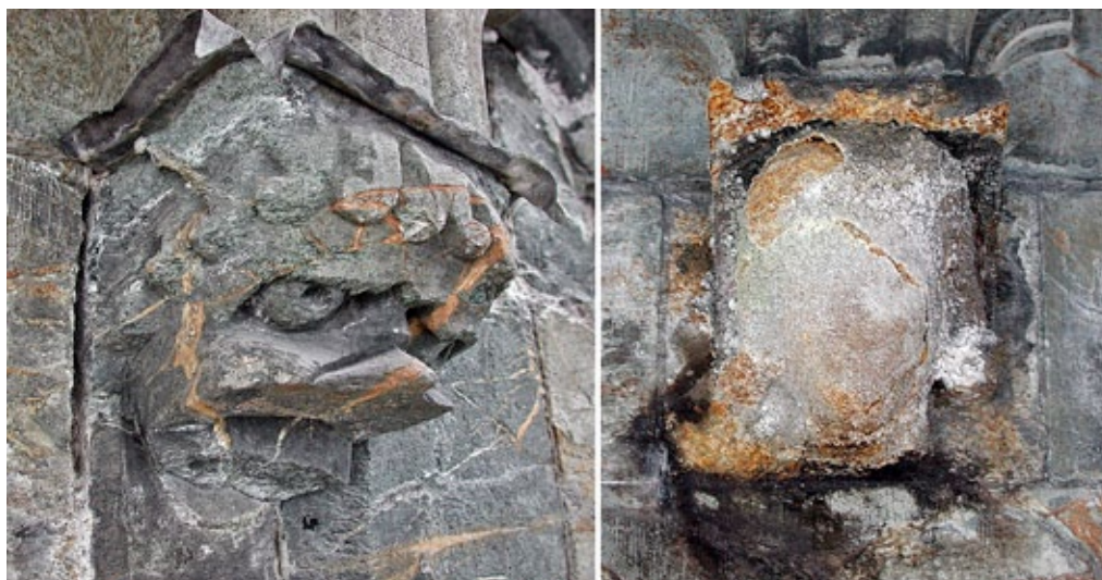
Figur 20. Konsoller på korets søndre hovedgesims før den nåværende restaureringen. Til venstre: Middelaldersk konsoll som har mistet hakepartiet langs kløven i steinen og ellers er preget av saltforvitring. Til høyre: Fullstendig ødelagt konsoll fra 1880-tallet i Grytdalstein. Den grå og delvis sorte skorpen som dekker hele ansiktet består av gips fra steinen. Fotos: P.Storemyr. Weathered corbels at the choir of Nidaros cathedral.
