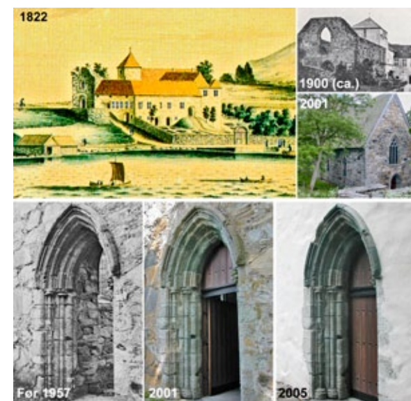
Figur 30. Vestportalen på Utstein kloster og det ruinerte skipet som ble reparert på 1800-tallet og lagt under tak i 1957. Portalen er preget av saltforvitring på grunn av tidligere lekkasjer. 1822: Maleri av Dreier. Fotos: 1900 og 1957 fra Fischer (1965), 2001 og 2005 P. Storemyr. The history of the west portal of the nave at the monastery of Utstein near Stavanger.
