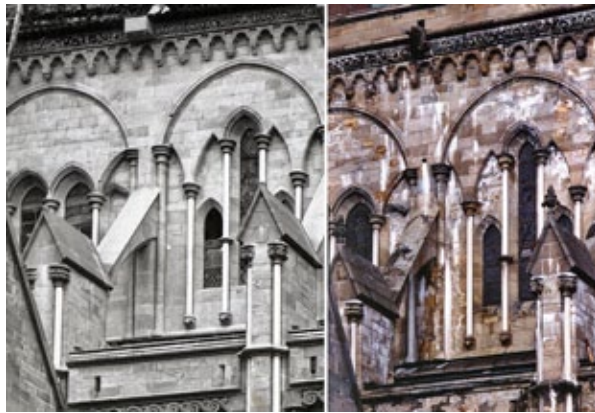
Figur 16. Sørsiden av Nidarosdomens kor med 100 års mellomrom. Til venstre: Like før restaureringen var ferdig i 1890 (Foto: NDR). Til høyre: Etter 100 år med vannlekkasjer, dårlig Grytdalstein og salt (hvitt på bildet). Foto: P.Storemøy 1994. The south wall of the choir at Nidaros cathedral in 1890 and 1994.
