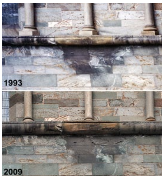
Figur 21. Sorte skorper under gesimsbånd på vestsiden av nordre tverskip. Rett under en naturlig forvitrende Grytdalstein (gul) har det dannet seg et felt med sorte skorper og salt. Disse kommer for en stor del fra steinen. Fotos: P.Storemyr. / Black crusts partially caused by natural weathering at the north transept of Nidaros cathedral.
