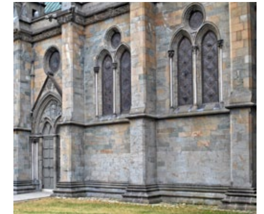
Figur 9. Nidarosdomen: Kleberstein i skipets nordvegg. Legg merke til skillet mellom homogen, grå kleberstein og stein av varierende kvalitet i feltet under vinduene. Rødlig kleber fra Østfold er satt inn under restaureringen. Foto: P.Storemyr. Nidaros cathedral: Soapstone at the north wall of the nave.
