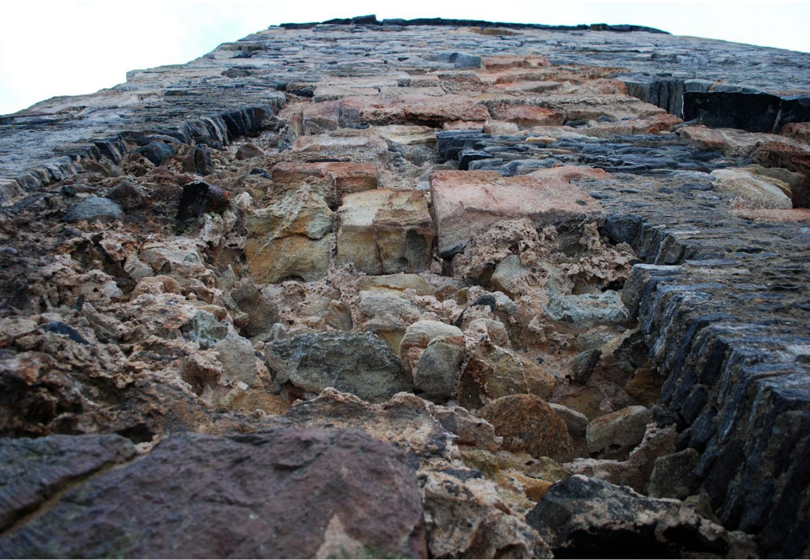
Figur 34: Forvitret murkjerne på tårnets østre fasade (skipets vestre vegg innvendig).
