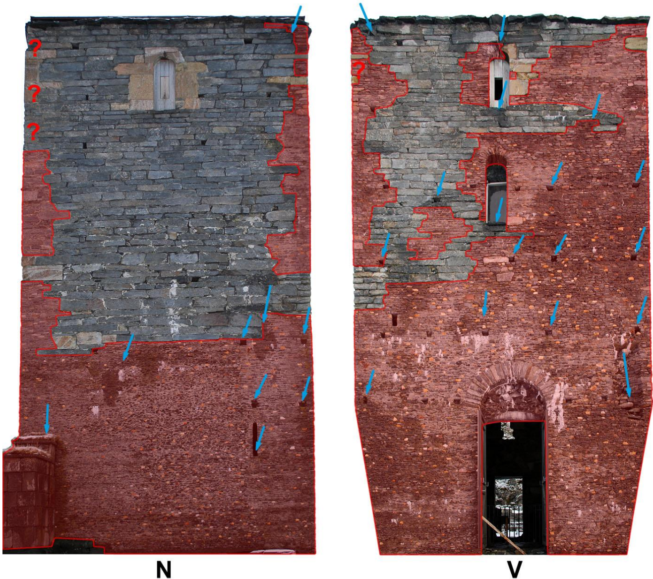
Figur 20: Restaurert murverk på nord- og vestsiden av tårnet. Skisse basert på observasjoner og fotos fra tiden omkring restaureringen i 1913. Blå piler angir potensielle lekkasjesteder. Foto fra en dag etter sterkt regnvær.
