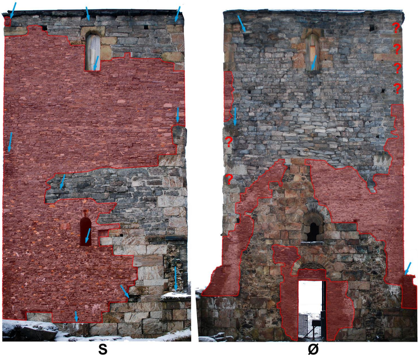
Figur 21: Restaurert murverk på sør- og østsiden av tårnet. Skisse basert på observasjoner og fotos fra tiden omkring restaureringen i 1913. Blå piler angir potensielle lekkasjesteder. Foto fra en dag etter sterkt regnvær.
