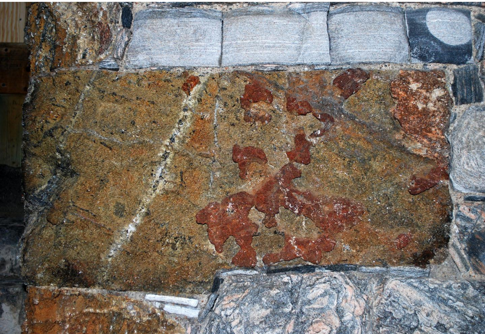
Figur 25: Brent olivinstein i tårnets tredje etasje. Legg merke til at fargen ytterst er blitt intenst rød og at det ytterste laget flaker av. Legg også merke til avrundingen av gneisblokkene. Dette er et tegn på saltforvitring.
