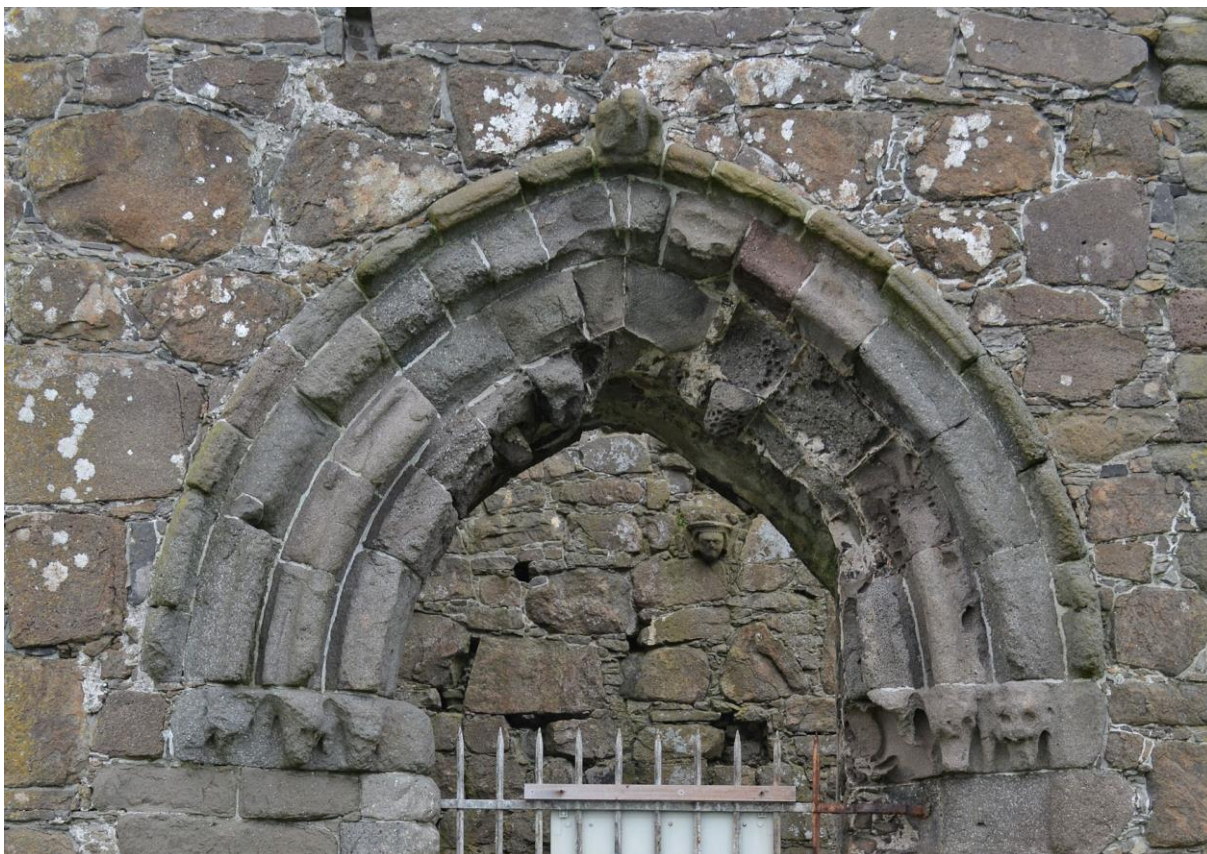
Figur 20: Sørportalen i skipet på ruinen av domkirken i Kirkjubøur. Selve murverket av hard basalt er i utmerket stand- De mykere og mer porøse steinene i portalen har betydelig forvitring, mest sannsynlig på grunn av salt. Saltforvitringen her kommer i en form vi kjenner som tafoni, som gir et hullet utseende. Foto: Per Storemyr.
