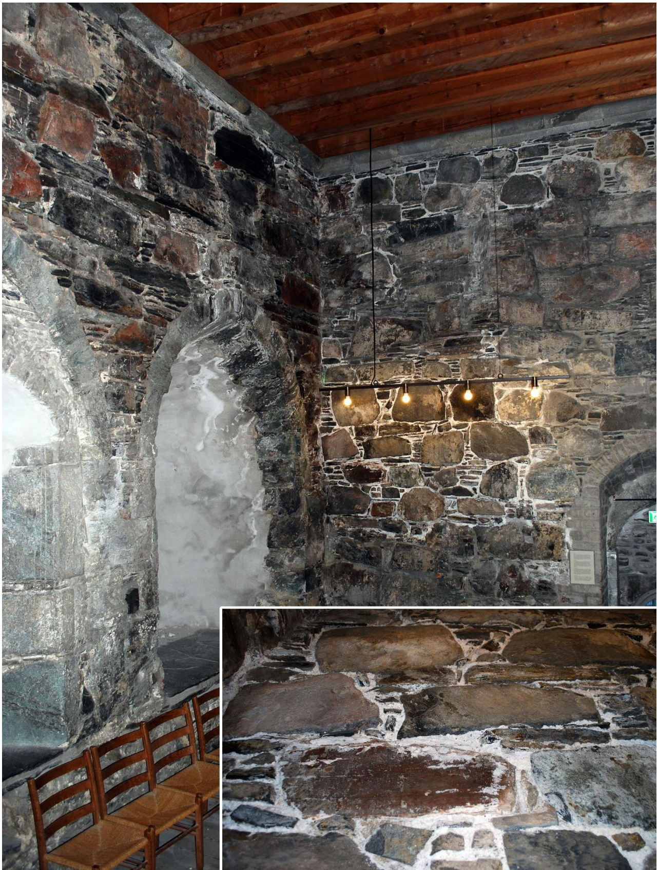
Figur 19: Rosenkrantzstårnet i Bergen er sterkt preget av saltforvitring innendørs. Her er det benyttet svært mye sement under restaureringer og de viktigste saltene er, ut fra egne observasjoner, natriumkarbonater og natriumsulfater. Foto: Per Storemyr.
