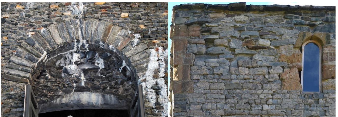
Figur 12: T.v.: Kalkskorper og stalaktitter i portalåpningen på vestfasaden indikerer fukt bak det restaurerte murskallet over. Bildet er tatt i 2010 og stalaktitten har blitt lengre etter den tid. T.h.: Forvitret middelaldermurverk med delvis åpne fuger på østfasaden, et helt annerledes murverk. Foto: Per Storemyr.
