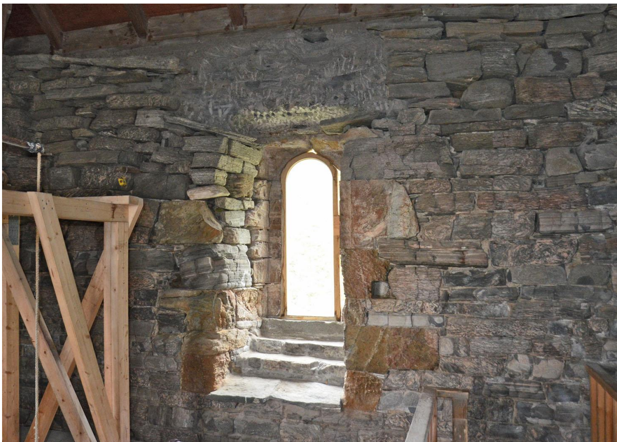
Figur 5: Østveggen i Albanustårnets tredje etasje – en god representant for tilstanden inne i tårnet. Vi ser at gneismurverket er sterkt forvitret og til dels uten mørtel i fugene. De gule steinene er forvitret metaolivinstein. Tilstanden til murverket er fortsatt preget av brannen på 1300-tallet. Foto: Per Storemyr.
