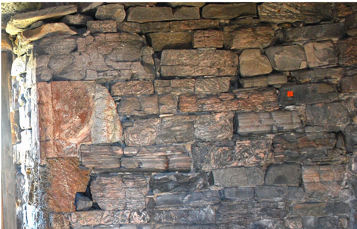
Figur 40: Det skadde gneismurverket slik det er å se på østveggen i tredje etasje. Legg merke til oppsprekningen og avrundingen av gneisblokkene – et tydelig tegn på brann og senere bl.a. saltforvitring. Foto: Per Storemyr.
