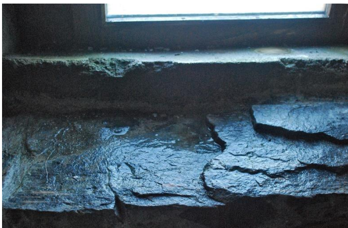
Figur 8: Det vestre vinduet i tredje etasje, 27. januar 2020. Her er det vått på grunn av en kombinasjon av lekkasjer og kondens. Foto: Per Storemyr.
