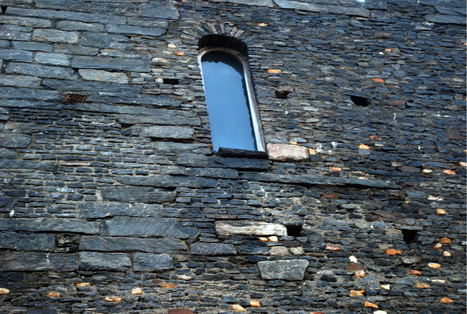
Figur 84: Vestveggen i Albanustårnet i dag, etter regnvær. Tett, restaurert sementbasert murverk med småfallen stein i lag med gammelt romansk murverk. Mange åpninger, inklusive stillasåpninger, og små sprekker der vann kan trenge inn. Foto: Per Storemyr.
