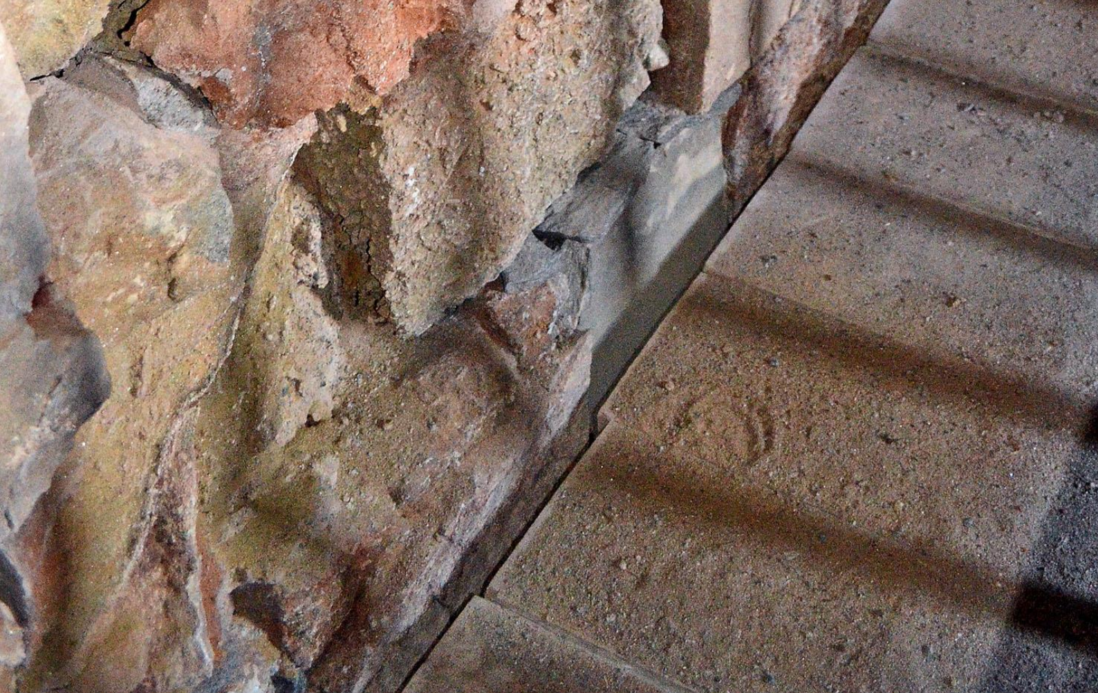
Figur 67: Store mengder nedfalt materiale fra forvitrende metaolivinstein i østveggen i andre etasje i tårnet våren 2017. Foto: Per Storemyr
