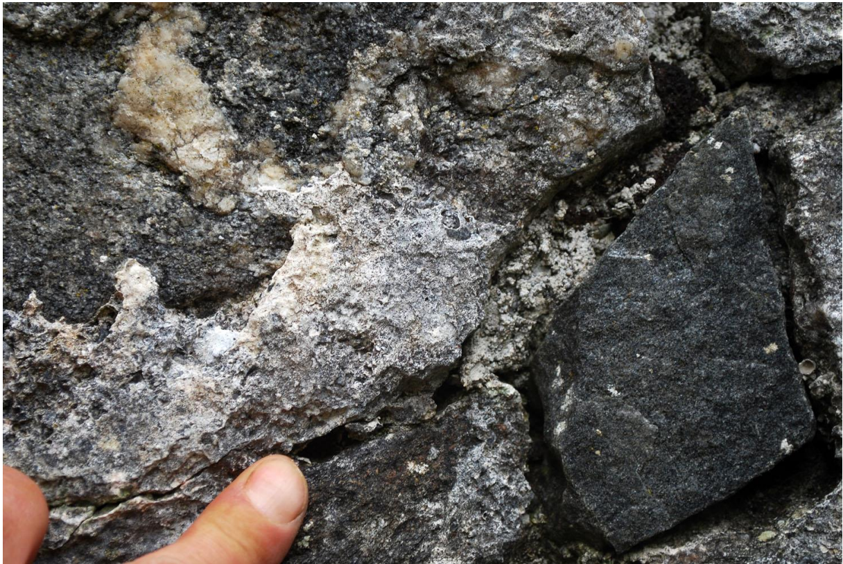
Figur 79: Nærbilde av kalkpussen i Figur 78. En svært forvitret kalkpuss som en gang kan ha vært forholdsvis tykk. Foto: Per Storemyr.
