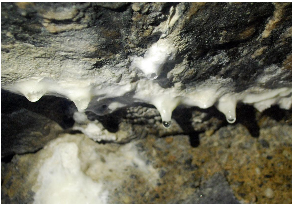
Figur 17: Stalaktitter i tredje etasje i Albanustårnet, over vinduet som vender mot vest. Stalaktittene er en indikasjon på svært fuktige forhold og har sin opprinnelse i oppløsning av kalk i sement (og delvis også gammel kalkmørtel). Foto: Per Storemyr.
