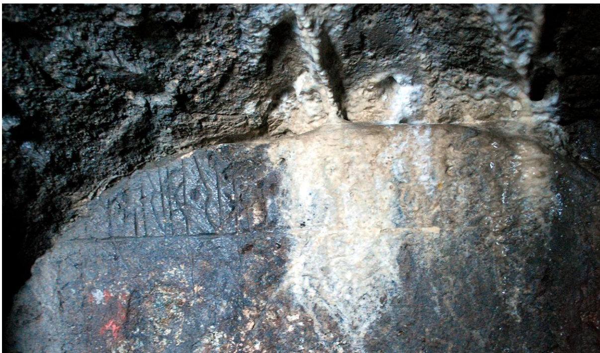
Figur 13: Et resultat av mye fukt i de vestlige deler av tårnet: Store deler av runeinskripsjonen i vindeltrappen i det nordøstre hjørnet er dekket av kalkskorper, utviklet som følge av lekkasjer, kanskje kondens og sementholdig mørtel. Foto: Per Storemyr 2010.
