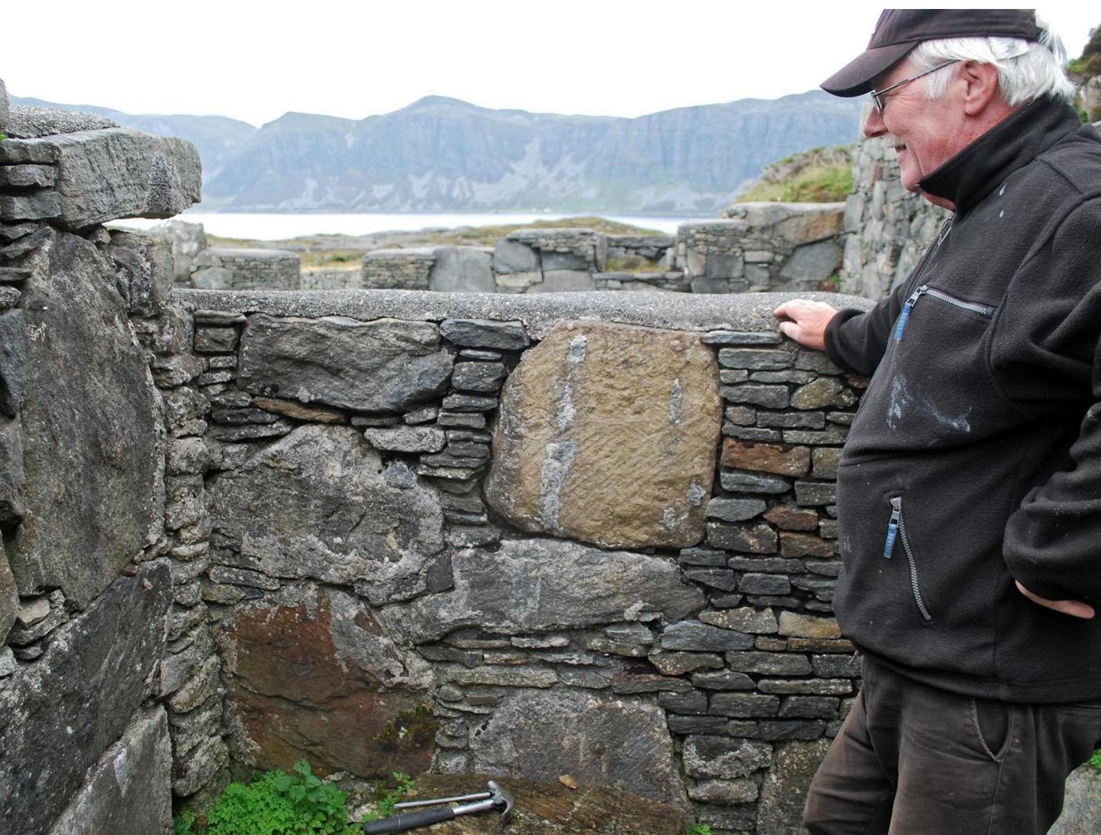
Figur 78: Bjørn Jensen viser den middelalderske kalkpussen på steinene (i ellers restaurert murverk) på sørsiden av Albanuskirkens kor utvendig. Foto: Per Storemyr.
