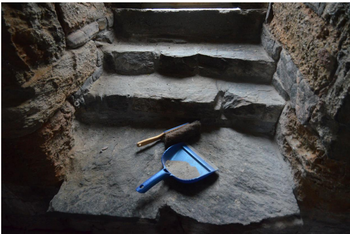
Figur 4: Oppsamling av nedfalt material fra på steinene i det østre vindussmyget i tredje etasje. Se bilde på neste side for oversikt over hele veggen: Foto: Per Storemyr, januar 2016.
