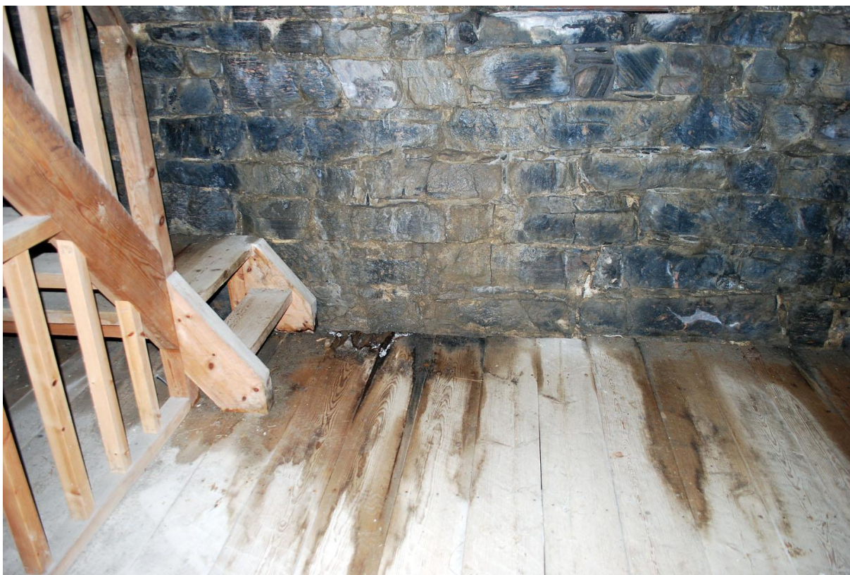
Figur 14: Et annet resultat av fuktige forhold: Råte i treverk på gulvet under vestveggen i andre etasje. Foto: Per Storemyr 2020.
