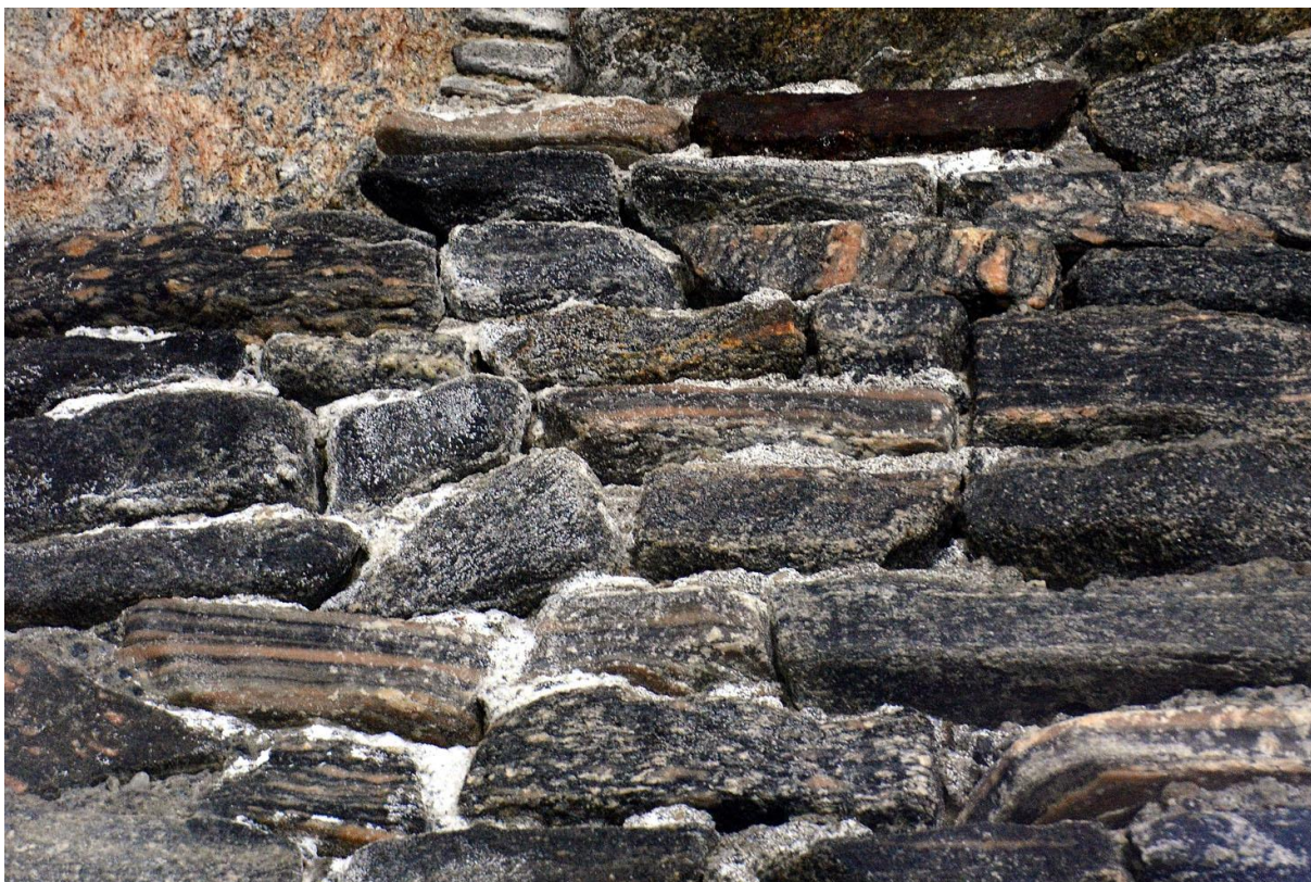
Figur 43: Saltutblomstringer (natriumkarbonat) på restaurert, småfallent gneismurverk satt i sement, første etasje. Foto: Per Storemyr.
