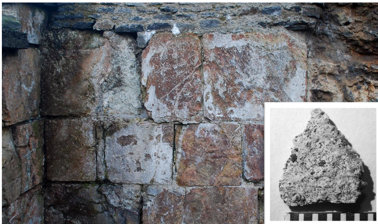
Figur 77: Rester etter tynn puss innvendig i Albanuskirken, på murverket som er del av tårnets nåværende østre ytterfasade. Innfelt: Makrofoto av kalkpussen. Vi ser småsprekker og tilslag av sand. mm-skala. Foto: Per Storemyr.
