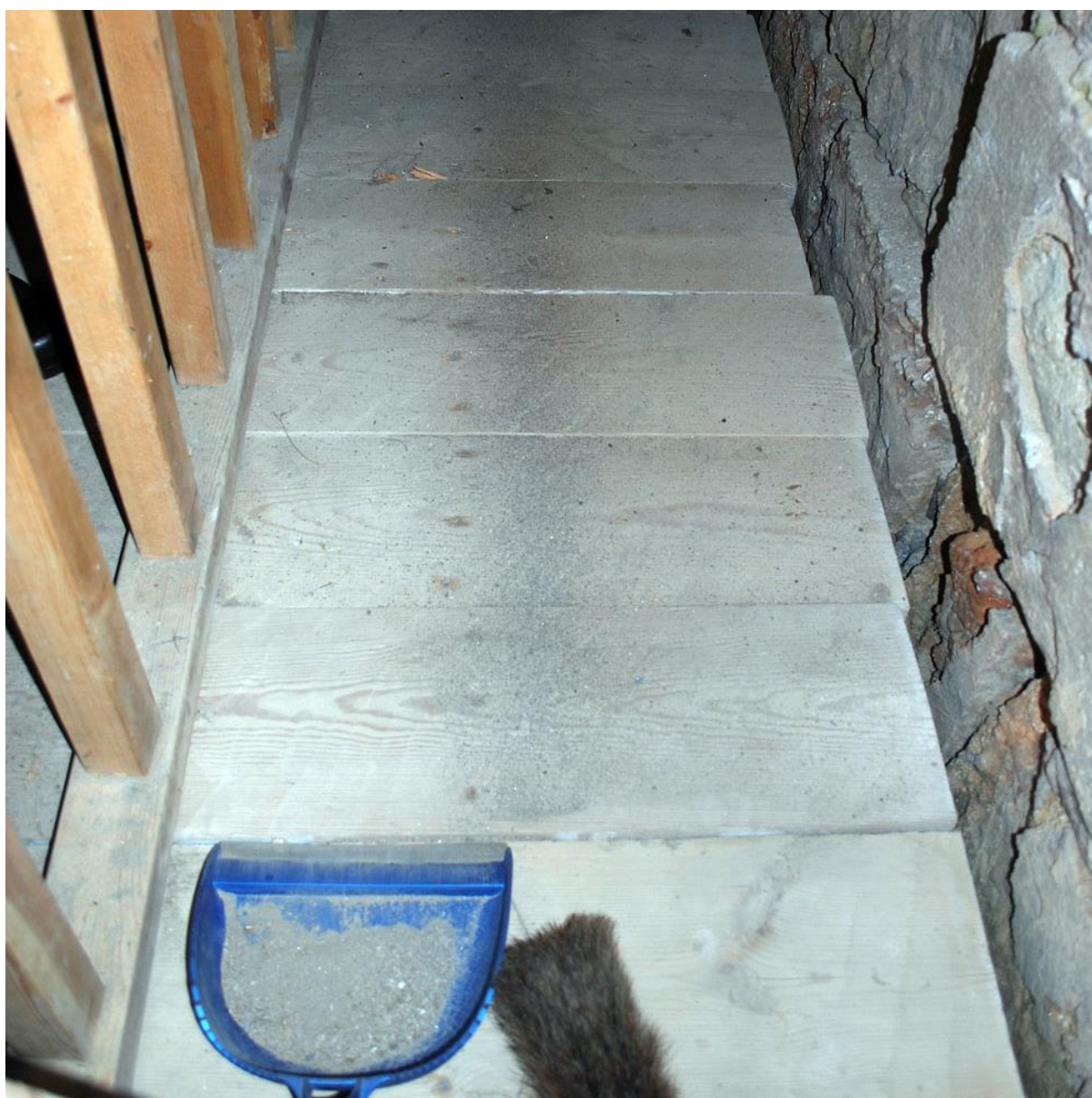
Figur 57: Oppfeiling av nedfalt material fra østveggen i andre etasje. Foto: Per Storemyr
