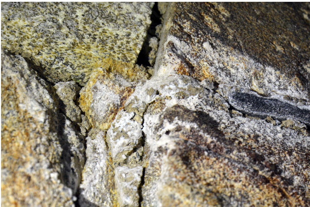
Figur 15: Salt og saltforvitring ved den østre portalen i første etasje i Albanustårnet. Her dreier det seg om natriumkarbonater. Bildet er tatt på en tørr septemberdag i 2016. Foto: Per Storemyr.
