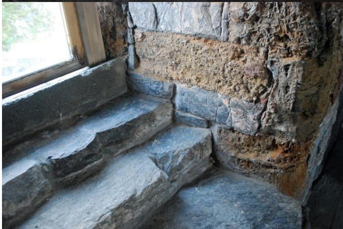
Figur 9: Det østre vinduet i tredje etasje, 27. januar 2020. Her er det helt tørt, jfr. figuren over. Foto: Per Storemyr.
