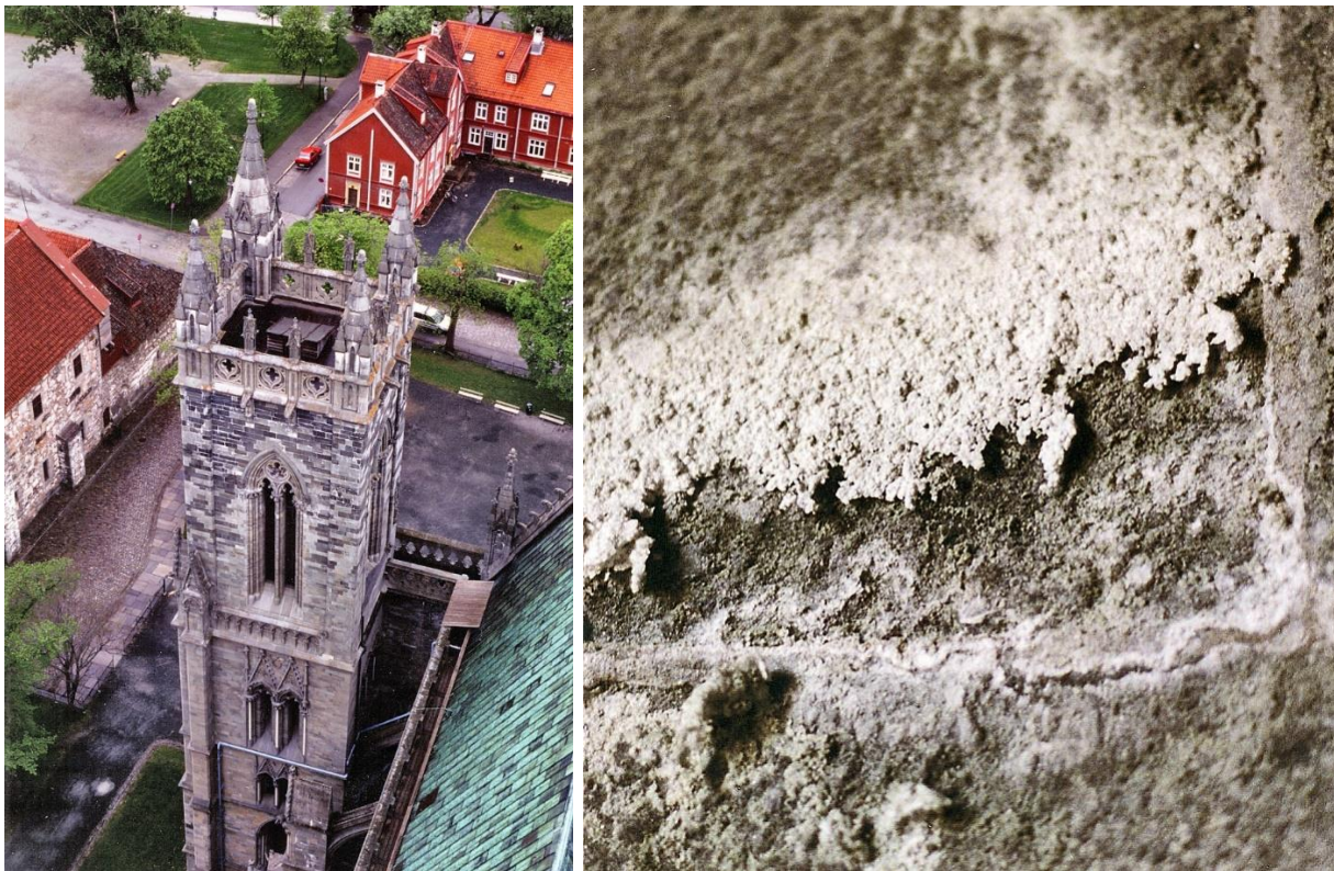
Figur 26: Nidarosdomens 50 m høye søndre vesttårn er bygd med sementmørtler og betong (øverste etasje) og kledd med kleberstein. Det var ferdig i 1969 og fikk nærmest umiddelbart store vannlekkasjer. Det har ført til massiv saltforvitring forårsaket av alkaliske natriumkarbonater i bl.a. den høye vindeltrappen. Foto: Per Storemyr.
