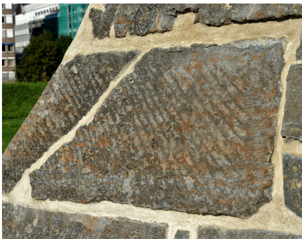
Fig. 15: Merker etter opprinnelig uthakking av ortocerkalkstein i steinbrudd, ved hogging av kanaler omkring steinblokken. Slik brytning var kun vanlig i myke steintyper. Skarpenords bastion, Akershus Festning. Foto: Per Storemyr.
