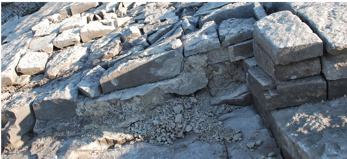
Figur 37: Ås 4, oppsmuldring av leire og mørtel fra konserveringsarbeidene i 2009.
