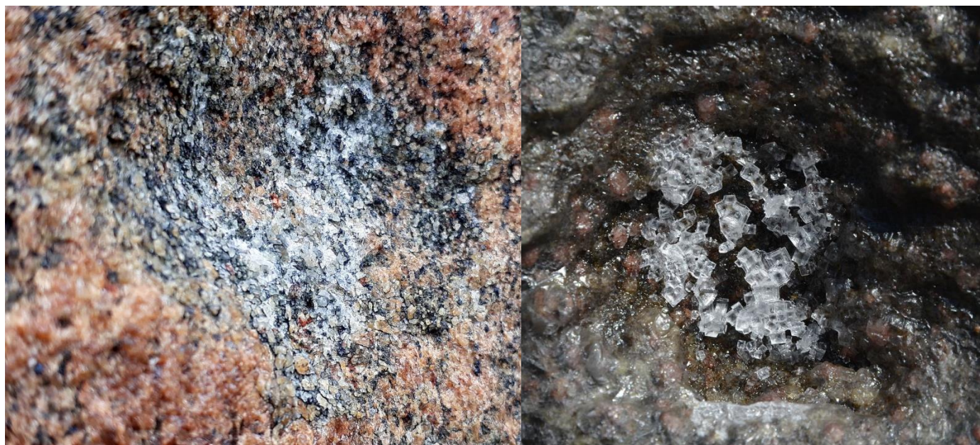
Figur 15: Venstre: Liten tafonigrop, 3-4 cm i diameter. Nede i gropa ser en at de enkelte mineralene har løsnet fra hverandre (granittisk gneis, Mærdø). Høyre: Det er ikke vanlig å kunne se salt i bunnen av tafonigroper, saltkrystallene er ofte for små til at en kan se dem og en må være på rett sted til rett tid – når det er tørt nok. Her er velutviklede krystaller av halitt (natriumklorid, koksalt) dannet ved fordampning av sjøvann i ei grop i fjæresonen i Hyllestad, gropa er ca. 5 cm i diameter. Her dreier det seg ikke om tafoni, men bildet antyder hvor mye salt som faktisk kan krystallisere i slike små groper, gitt at værforholdene er gunstige (tørt etter at mye vann har skylt opp).
