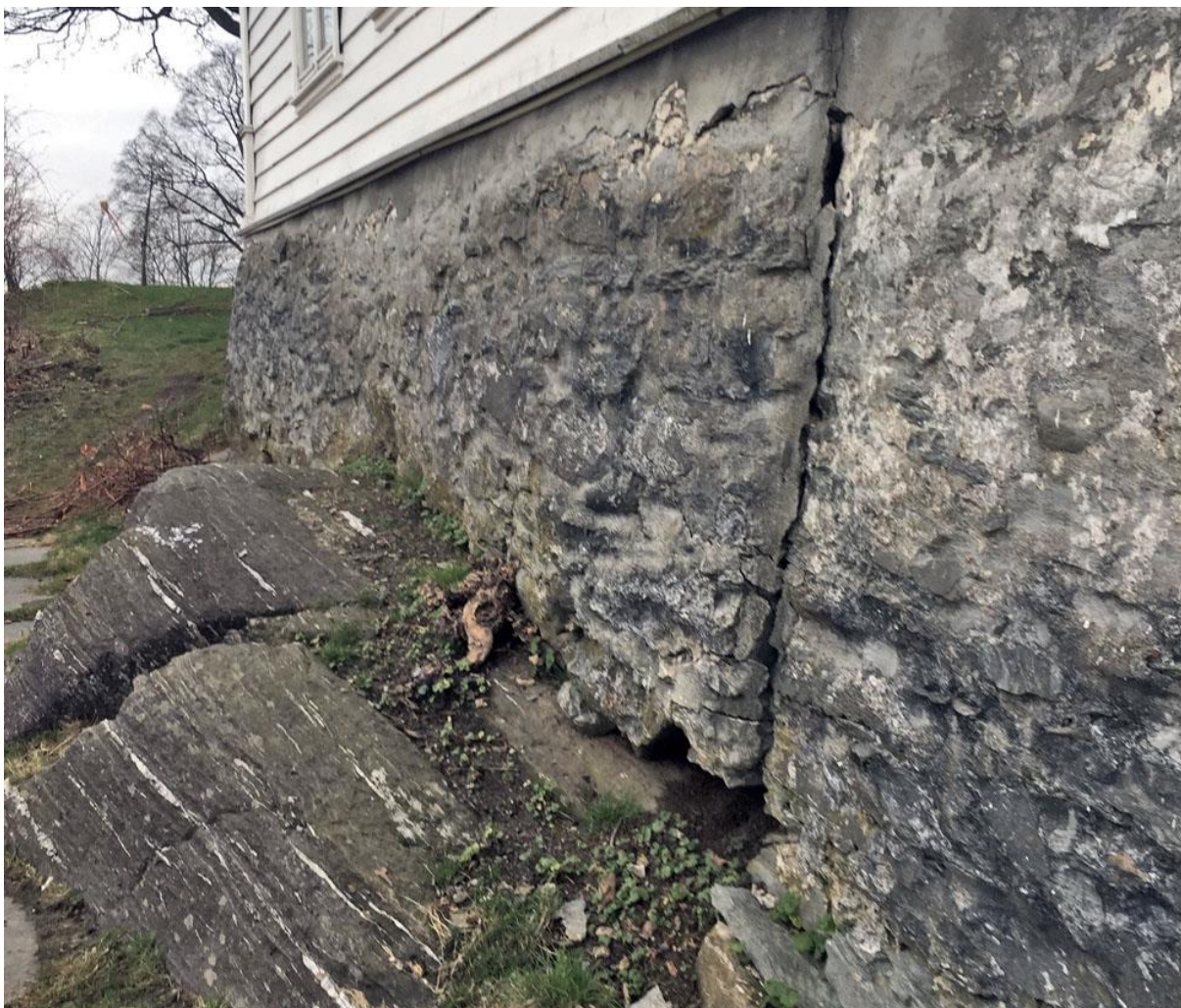
Den forvitrede muren før arbeidet ble satt i gang. Foto: Åse Tveitnes.
